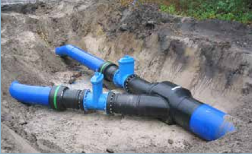
Abzweig, Projekt in Deutschland Branch, project in Germany
