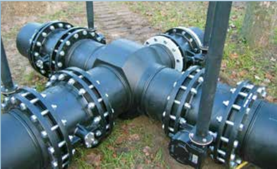
Kreuzstück, Projekt in Deutschland Cross, project in Germany
